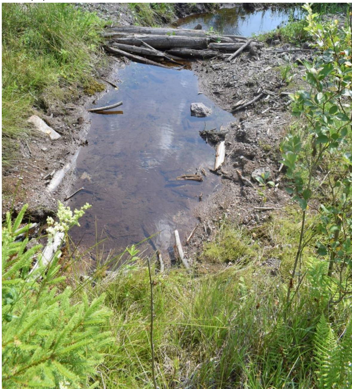
Obrázok č.5 Vytvorenie sústavy jazierok nad, v ceste a pod cestou, pre spomalenie odtoku vody a jej filtráciu pri prechode cez cestu.
