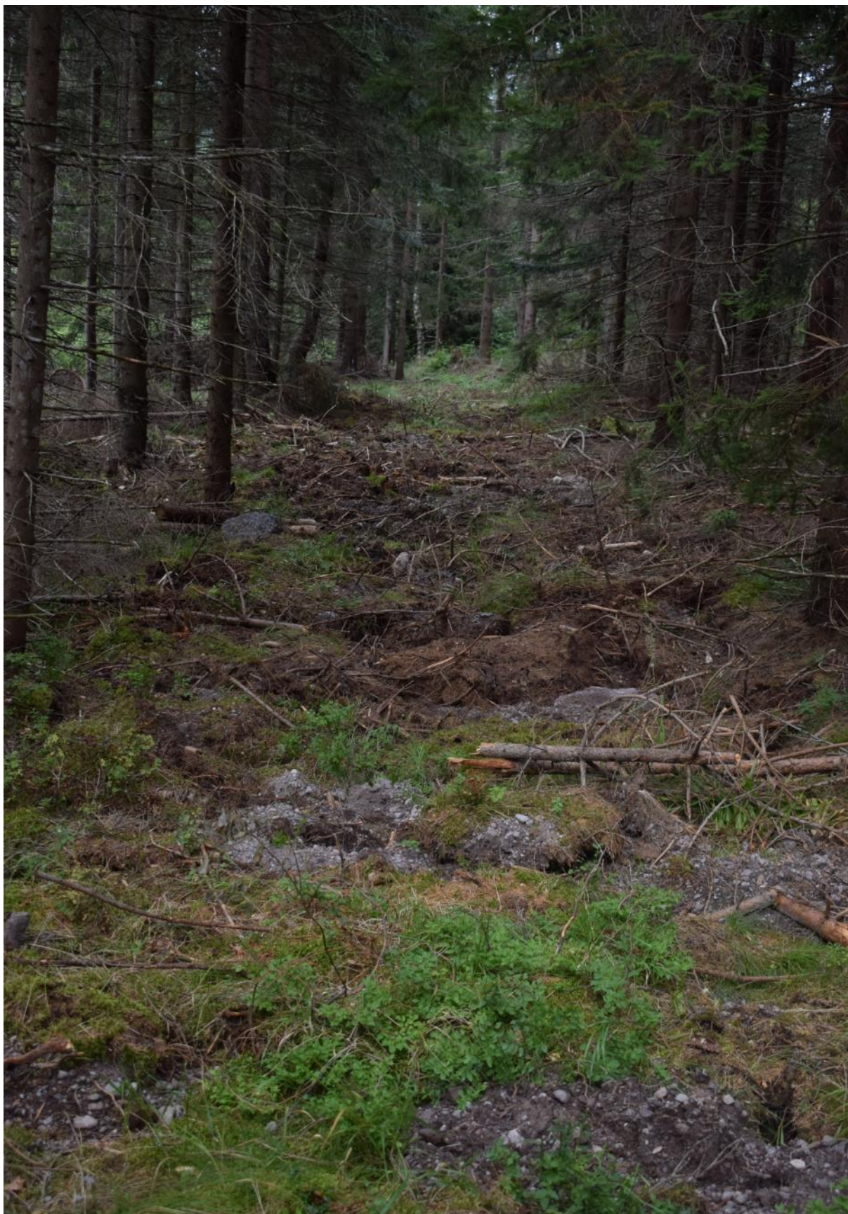
Fotodokumentácia - Obrázok 8: Revitalizácia nepotrebných liniek v miernejších svahoch formou prekopania utlačených vrstiev bývalej cesty, s infiltračnými prvkami po okrajoch
